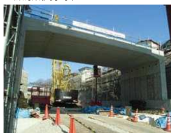
▲東京都北多摩南部建設事務所 11800 x 5300 4分割タイプ
